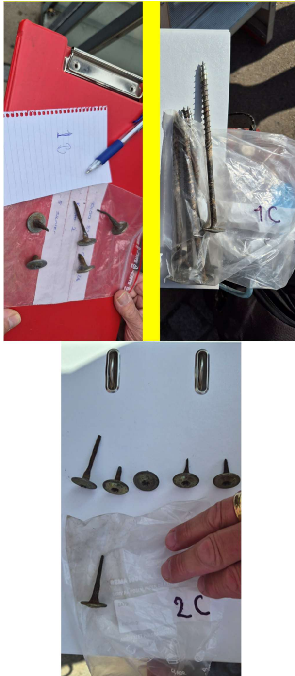
Figur 3.3 Gennemtærede skruer (hoveder) fra den nedstyrtede altan på 3. sal (1B) og næsten intakte skruer (1C) fra den nedtagne altan på 2. sal lige under den nedstyrtede altan samt gennemtærede skruer (2C) fra den nedtagne altan på 2. sal til højre for altanen med de næsten intakte skruer.
