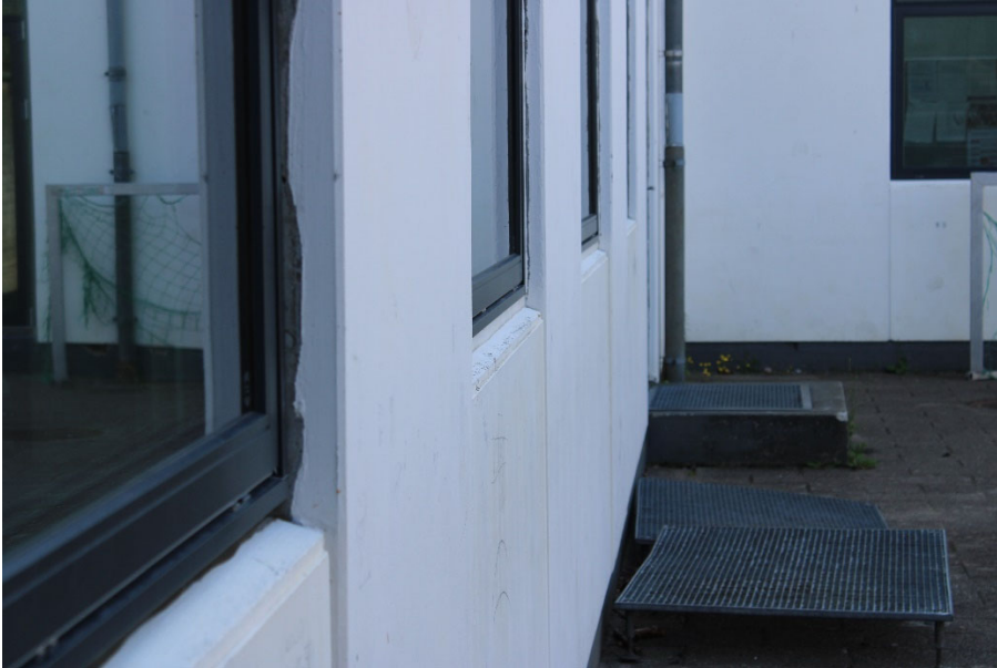
Figur 9. Facadeelementer i nederste etage i bygning med 2 etager. Bemærk udbøjning af facadeelement ved vindue.
