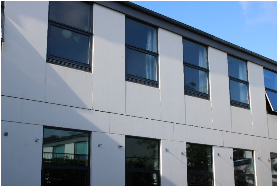
Figur 8. 2 etages bygning. Bemærk udbøjning på midt af facadeelementer i øverste etage.
