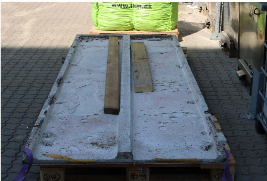
Figur 14. Nedtaget facadeelement, med afstivende lodrette armerede udstøbninger.
